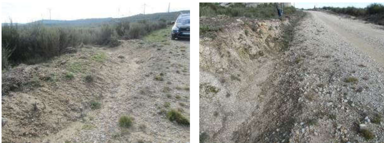
Fotografias 4.4 e 4.5 – Exemplo de valetas sem revestimento, observando-se à esquerda como é efetuado o encaminhamento do escoamento para a linha de água mais próxima
